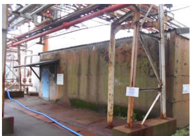
PCB廃棄物保管倉庫(関西工場尼崎事業所)
