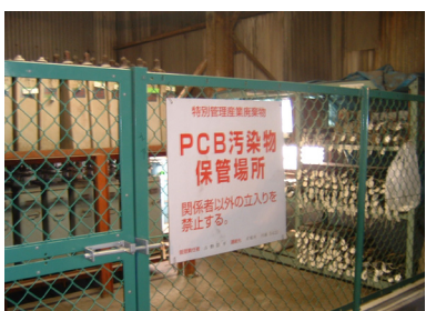
PCB廃棄物保管場所(AGC横浜テクニカルセンター)
