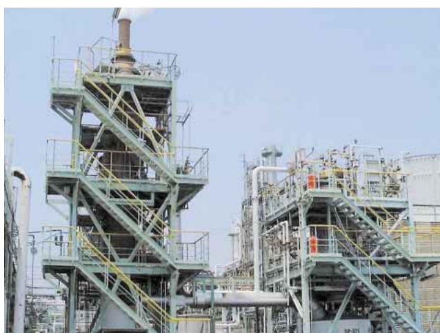
フロン破壊設備
